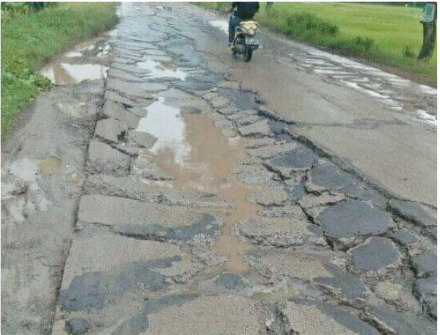
Jalan Beyeh-Simpang yang sudah sangat rusak parah
